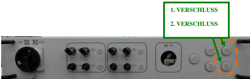
Abb. 24 - Kabeldurchgänge für die RS-485-Verbindung
